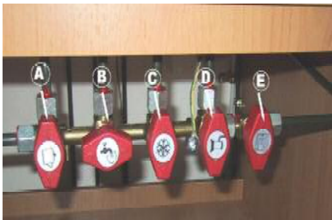
CENTRALINA COMANDO GAS
