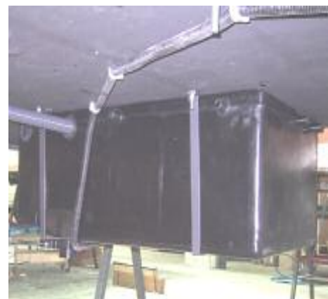
SERBATOIO ACQUE SCURE
