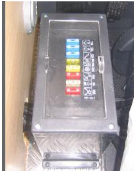
PORTAFUSIBILI FISSATO AL PAVI- MENTO
